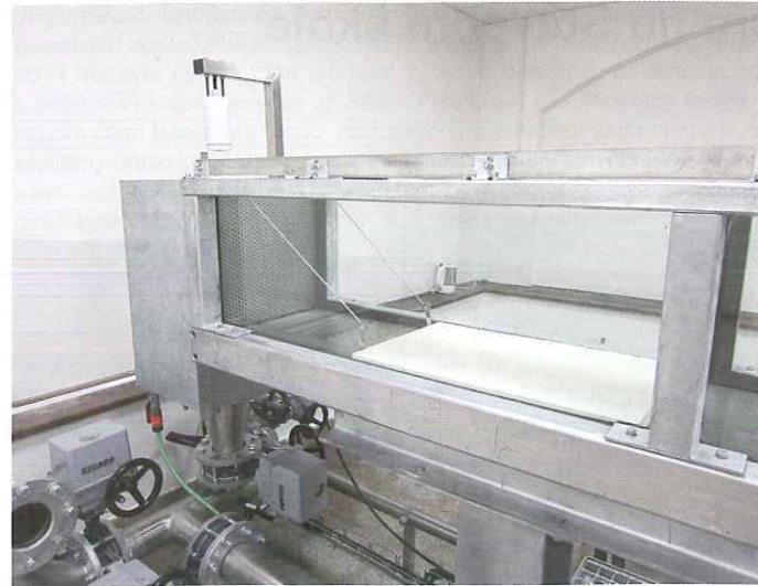
Obr. 4: Přítoková část měrného žlabu s tlumícími a stabilizačními prvky proudových poměrů a ultrazvukovým měřením hladiny
